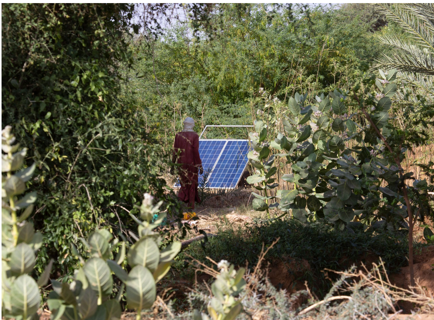
Les panneaux solaires installés par le projet permettent aux bénéficiaires d'utiliser leurs puits et avoir accès à l'eau
